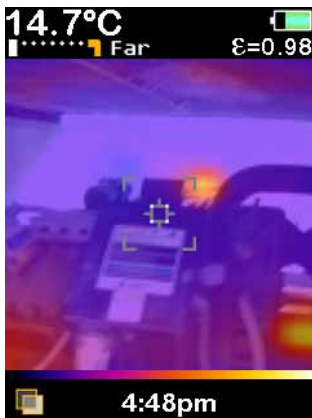
Compressor da fase 2
